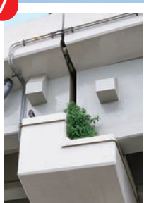
首都高速7号線の橋脚に樹木？を発見！
